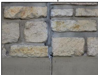
Photo N° 2837 ECH-N°5 -- Batiment 23-31 republique Murs Joint de dilatation+mousse
