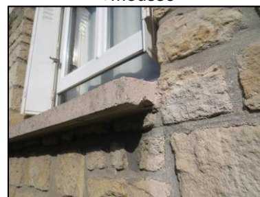
Photo N° 2855 ECH-N°12 -- Batiment 23-31 republique façade jardin Appui de fenêtres béton+peinture
