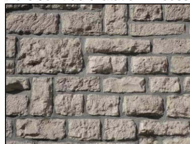
Photo N° 2875 ECH-N°25 -- Batiment Laennec façade parking Murs Joint entre pierres
