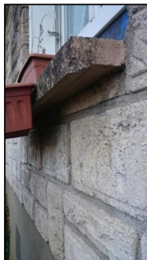
Photo N° 347 ECH-N°53 -- Batiment calmette façade arrière Appui de fenêtres béton+peinture
