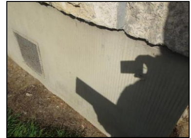
Photo N° 2886 ECH-N°30 -- Batiment Ambroise façade parking Murs soubassement béton+peinture
