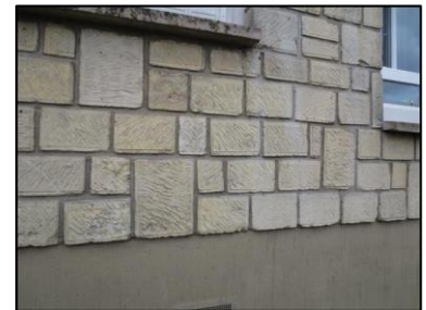
Photo N° 2895 ECH-N°35 -- Batiment 28-36 republique façade parking Murs Joint entre pierres
