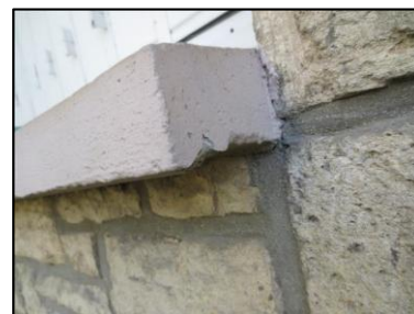
Photo N° 2861 ECH-N°15 -- Batiment Laennec façade jardin Appui de fenêtres béton+peinture
