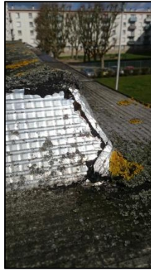
Photo N° 337 ECH-N°43 -- Batiment place villemin Toiture Casquette commerce Etanchéité type "paxalu"
