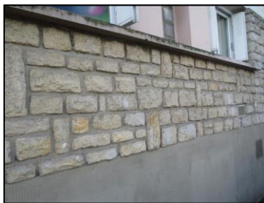
Photo N° 2832 ECH-N°2 -- Batiment 23-31 republique Murs Joint entre pierres
