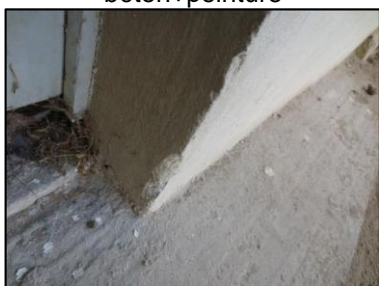
Photo N° 2865 ECH-N°19 -- Batiment Laennec façade jardin Murs béton+peinture marron
