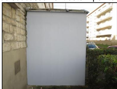
Photo N° 2834 ECH-N°4 -- Batiment 23-31 republique Murs extérieur hall 25 béton+peinture
