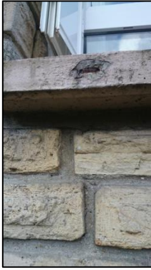
Photo N° 329 ECH-N°40 -- Batiment 24-26 republique façade pignon Appui de fenêtres béton+peinture
