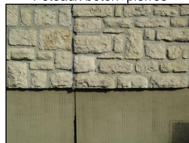
Photo N° 2851 ECH-N°9 -- Batiment 23-31 republique façade rue Murs Joint de dilatation +mousse
