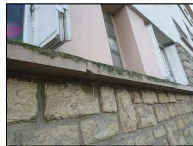
Photo N° 2833 ECH-N°3 Appui de fenêtres béton+peinture
