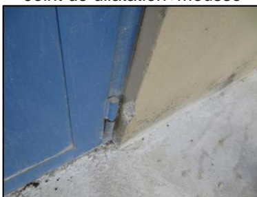
Photo N° 2846 ECH-N°8 -- Batiment 23-31 republique Murs béton+peinture marron
